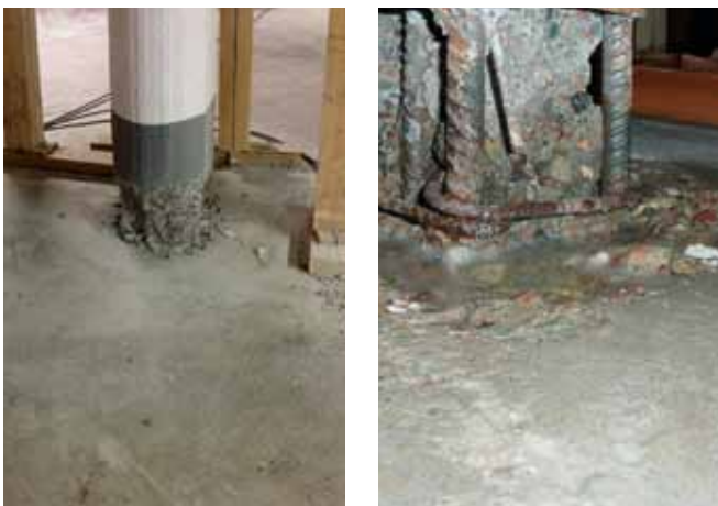
Abbildung 3 (links): zusätzliche Abstützmaßnahmen mussten vorab ausgeführt werden Abbildung 4 (rechts): Die Chloriduntersuchungen wiesen sehr hohe Eindringtiefen auf, so dass der Beton bis hinter den Bewehrungsstahl abgetragen werden musste
